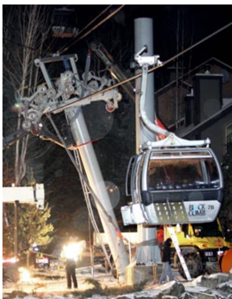
фиг.7 Разрушаване на стълб от кабинков лифт
